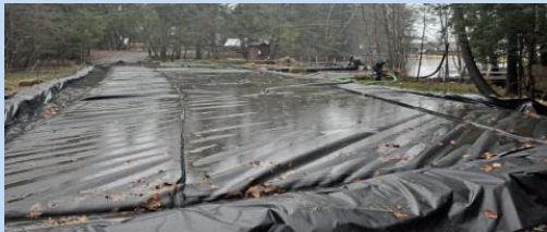
Geotextiles impermeables donde se depositan los residuos de succión (almejas, sedimento y agua)
